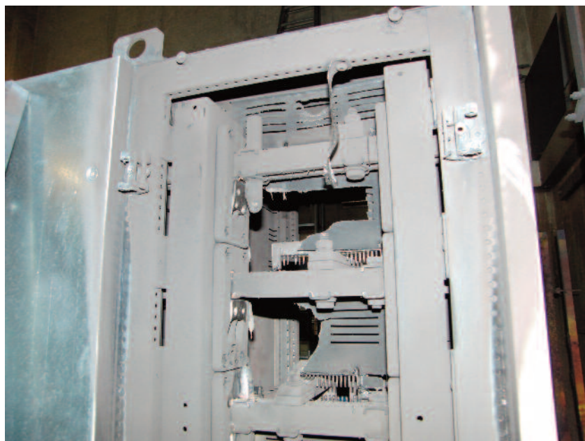
Efekt zniszczeń wywołanych przez zwarcie łukowe.
